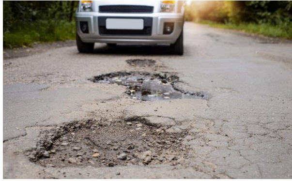
Imagen 99 - Ejemplo de Socavón. Caso de Bache en Rodadura (MOTOR El País)
